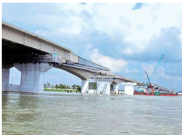
両岸の架設ヤードから中央へ向かって2方向の送出し架設を行った
